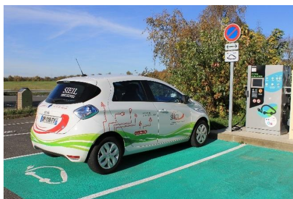
Station de recharge rapide sur l'A10
